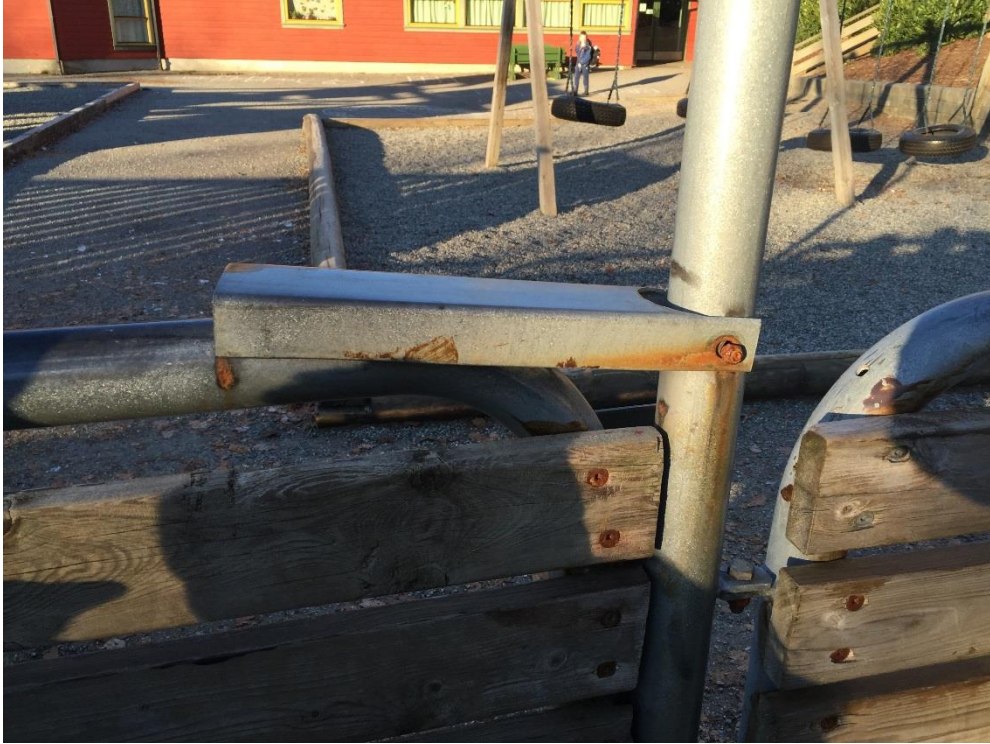
Foto: Skade på port
