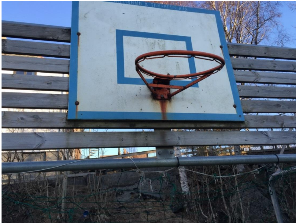
Foto: Skade på basketballkorger
