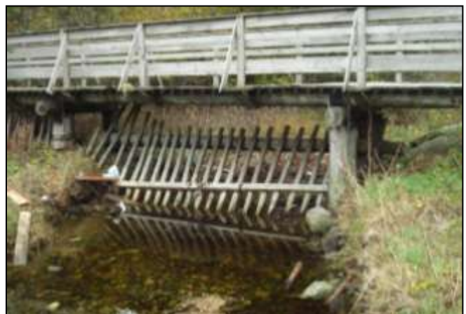
Stengsle for søppel i bekken mellom Valevågen og Straumen.
